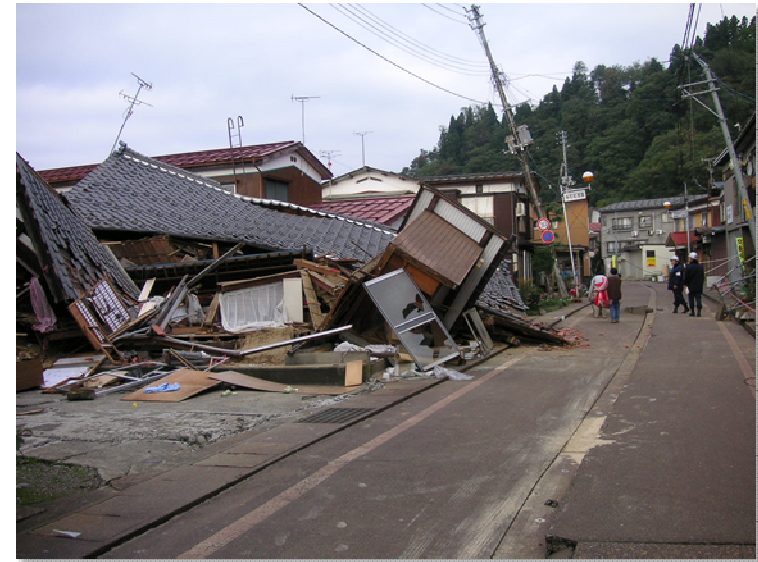
地震による木造住宅の倒壊 (※写真は新潟県中越地震発生時の旧川口町の様子)
